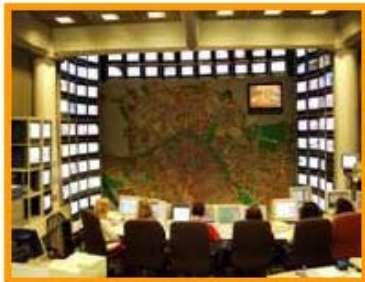
SALA DE CONTROL DE TRÁNSITO
